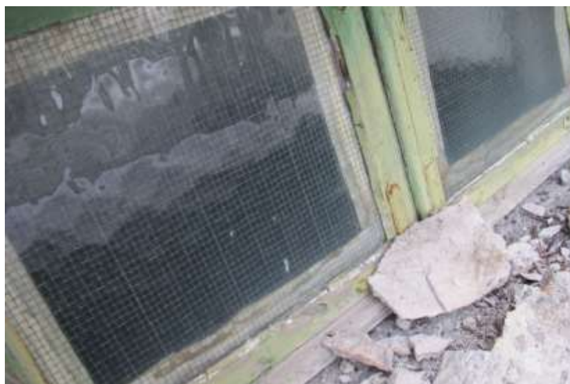
Alle vinduer i sokkel, trenger rehabilitering
