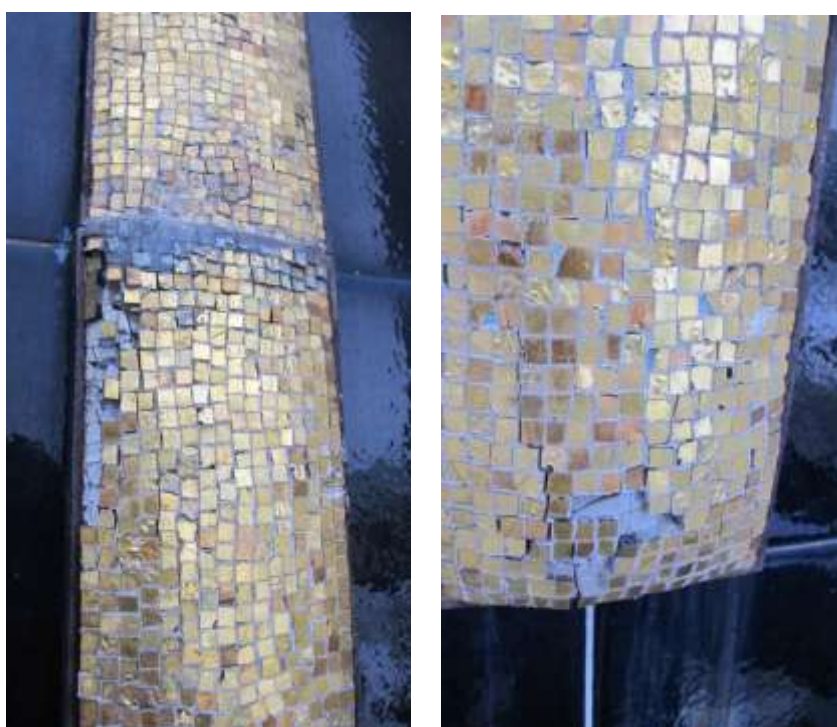
Korset som utgjør utsmykning av byggverket i front trenger vedlikehold. En del av mosaikkflisene er falt av, og en god del er i ferd med å løsne.
