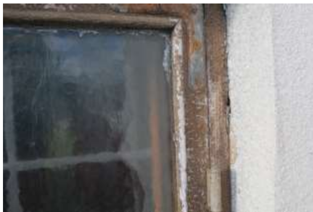
Uttørket trevirke, noe råteskader, delvis manglende kitt, avskalling
