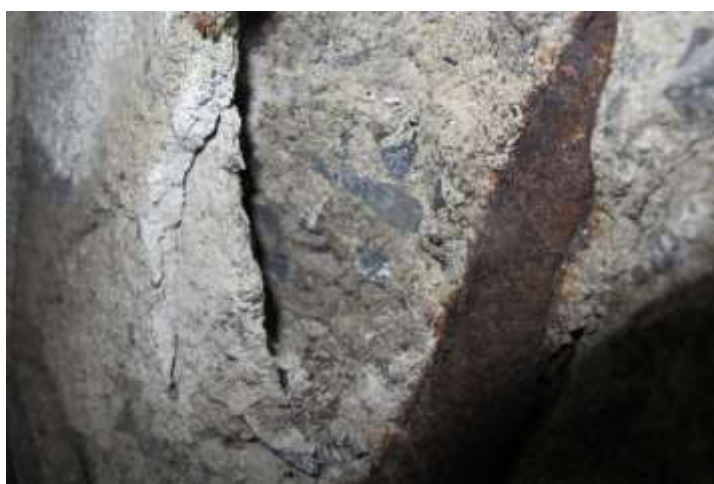
Alvorlig armeringskorrosjon med svekkelser opp til 30 %
