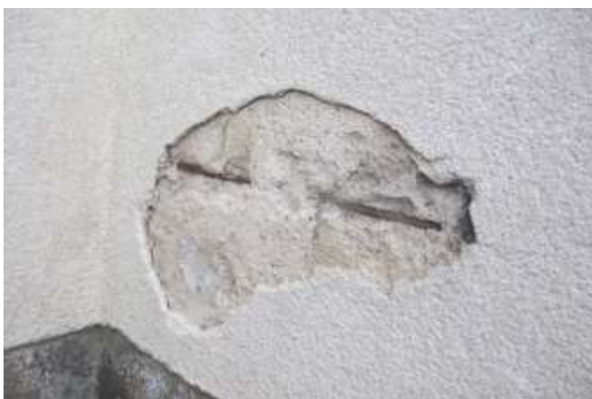
Nyere slipp med underliggende armeringskade i innlagt pussarmering.
