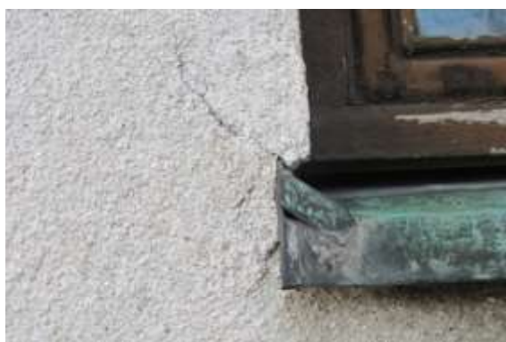
Typisk mekanisk skade i fasaden fra tekking.
