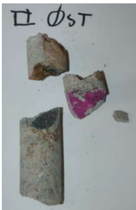
Bilde 10 Bruddflatene er påført Fenolftalein. Karbonatiseringsfronten er dypere enn armeringen og jernet har korrodert.
