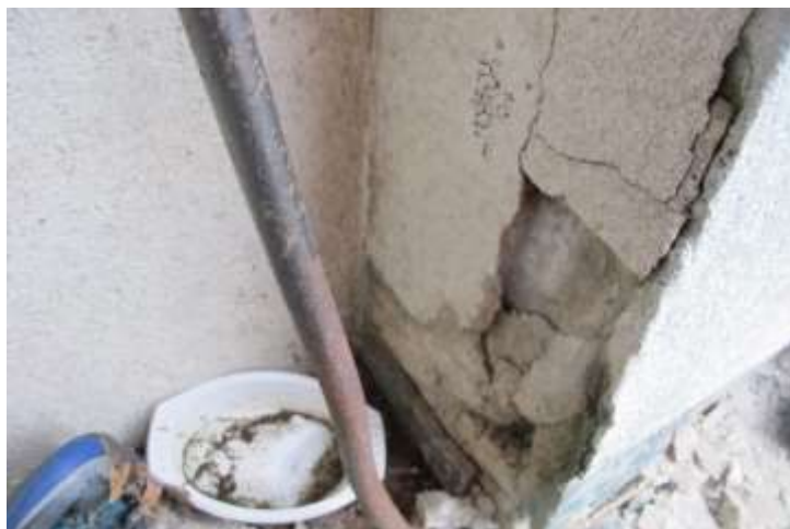
Gjennomgående sprekk som er rast ut
