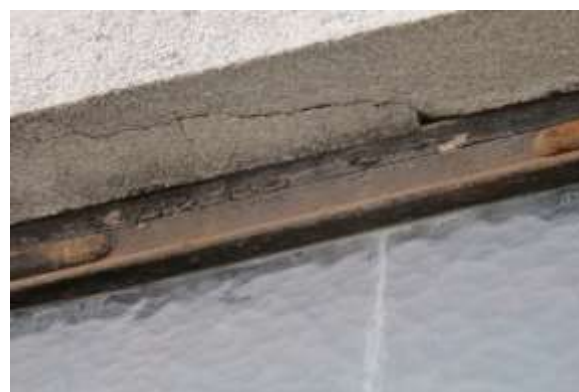
Utsprenging over vindu, antatt korrosjon i drager.
