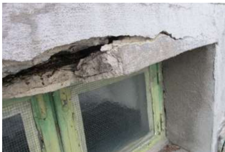
Alvorlig korrosjon i overliggere
