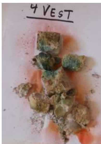
Bilde 6 Under boring av støv for kloridsanalyser, gikk kjernen i oppløsning. Bruddflatene er påsprøytet Regnbueindikator. Fargene viser at hele betongkjernen er karbonatisert. Det er noe flekker med høyere pH-verdier. Dette kan en ofte finne på gamle betongkonstruksjoner der utstøpning og komprimering har vært ujevn. Områder der eldre grov sement ble godt komprimert, vil karbonatisering ta svært lang tid, mens i tilstøtende områder med mer porøs betong, har \text{CO}_2 hatt god tilgang og all sement er karbonatisert.
