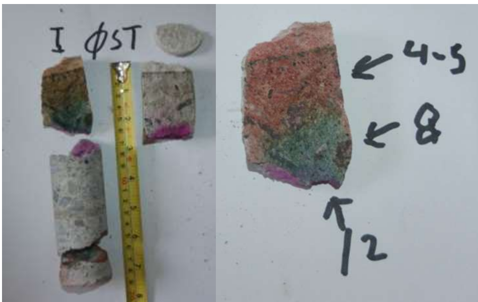
Bilde 8 Venstre bruddflate er påført Regnbueindikator, men høyre bruddflate er påført Fenolftalein. Armeringen ligger bruddflaten. En ser at betongen er karbonatisert til dybde 50-60mm, dvs inn til armeringen. Bilde til høyre er en forstørrelse av overdekningen påført Regnbueindikator. En ser at det inn mot armeringen er et lite område med pH-verdi ca. 13. Utenfor ser en et område med pH-verdi ca. 8-9. Dette viser at det er dannet kalk og jern i slik betong vil ikke ha intakt passivfilm. Ytterst mot puss ser en at pH-verdien er kommet ned mot 4-5. Dette tyder sterkt på at kalken har reagert videre med sulfater og at gipsforbindelser er dannet. Dannelse av gips vil gradvis svekke fastheten.
