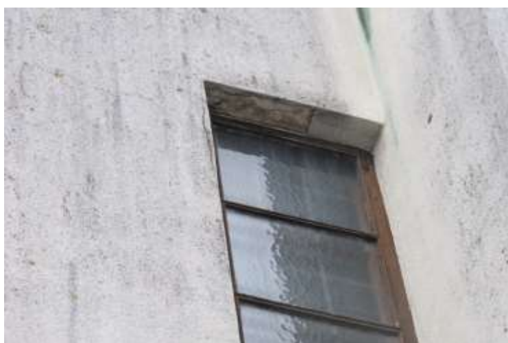
Underpuss og mineralittpuss har sluppet og falt ned. Selv små pussbiter fra denne høyden kan føre til alvorlige personskader. Under ser man tydelig utvikling
