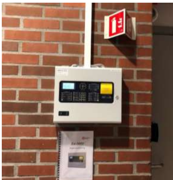
Gasslukkeanlegg utenfor SOX-rom.
