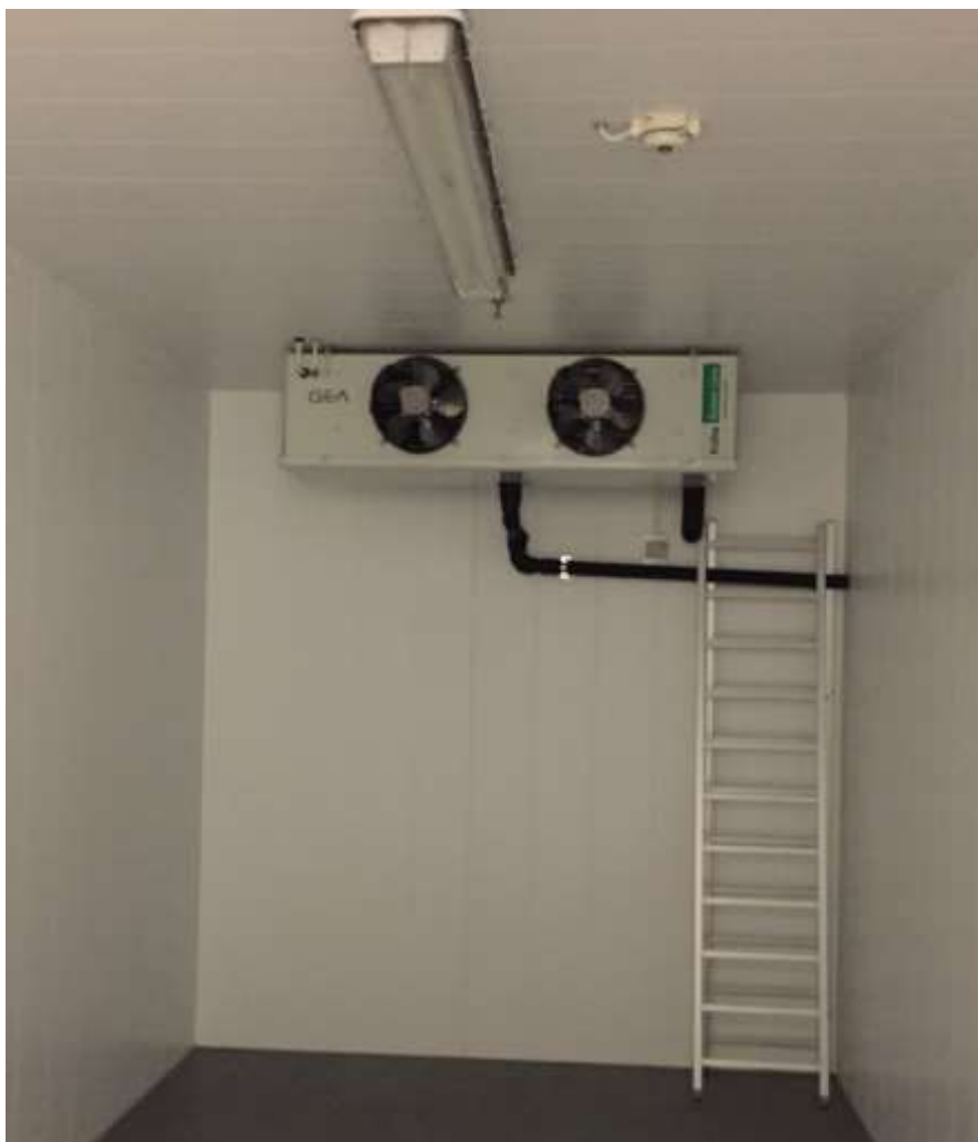
Bilde fra fryserom.
