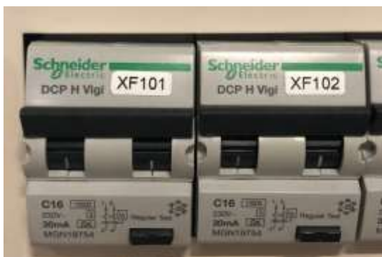
Jordfeilvern i en typisk underfordeling
