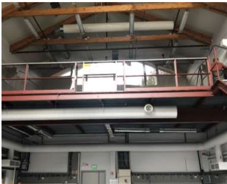
Rom B-12: Mezzanin rives og installasjoner må fjernes.
