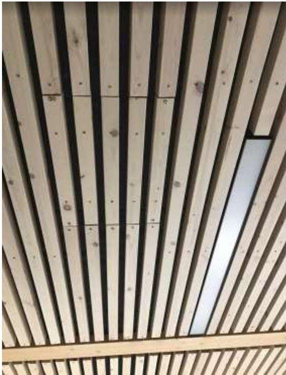
innfelte armaturer og inspeksjonsluke
