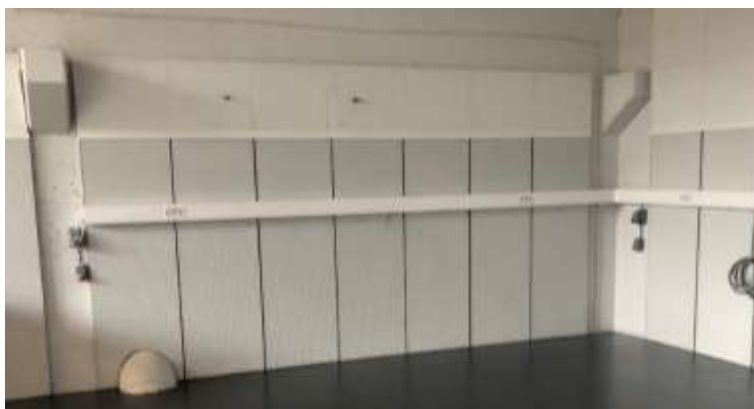
Mezzanin: Installasjonskanal langs vegg må demonteres.
