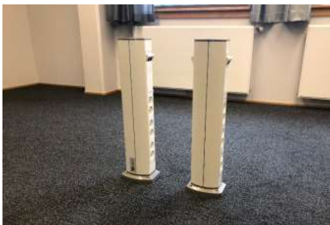
Kontorlandskap A-101: Frittstående uttakssøyle.
