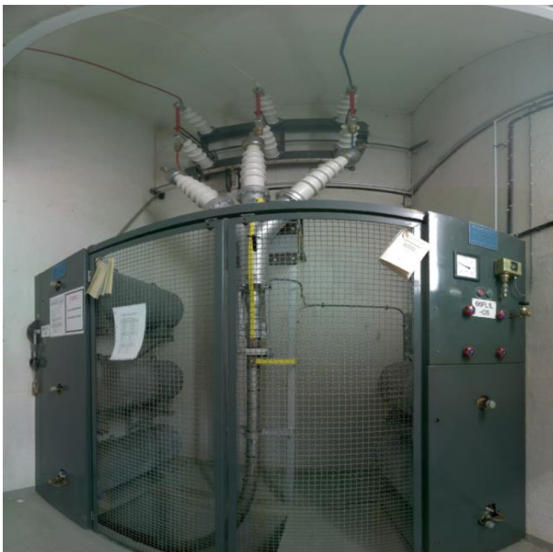
Figur 6-1: Eksisterende kabel-innføring og 72,5 kV celle i Hemmingstad transformatorstasjon
