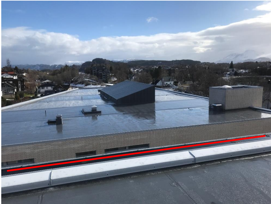
Figur 9: Bilde viser østside på C-blokk med tak utenfor gesims (K-bygg i bakgrunnen). Rød linje viser tak utenfor gesims.
