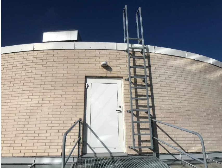
Figur 7: Bilde viser eksisterende leider på rotunde. Denne må erstattes.
