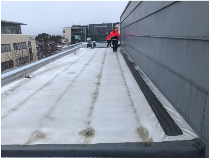
Figur 4: Bilde viser område på øst side av hovedtak på L-bygg, sikring for tilgang til sluker ved gesims er nødvendig.
