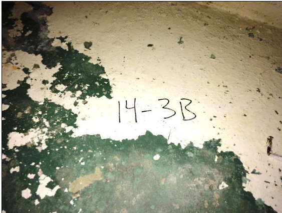
Figur 9: Maling som er farlig avfall.
