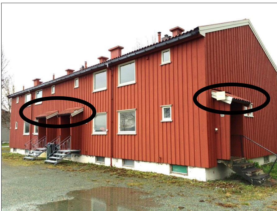
Figur 1: Tingvollen 8 er et av byggene som fortsatt har opprinnelig takkledning av bølgeeternit.
