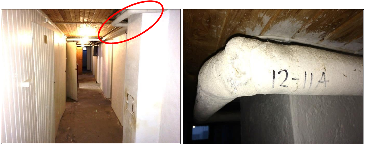
Figur 4: Rørisolasjon på vannrør i felleskjelleren i Tingvollen 11 inneholder asbest (rørbendene).
