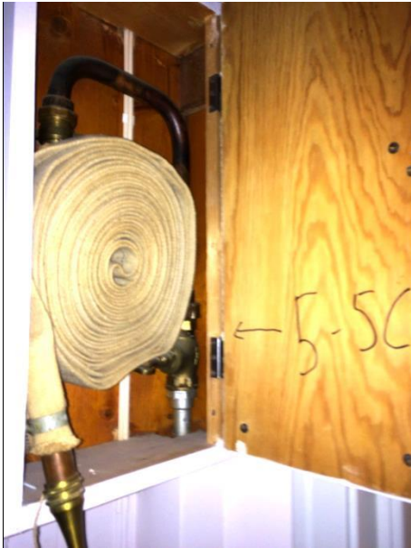
Figur 6: Brannslanger i leilighetene inneholder ikke asbest.
