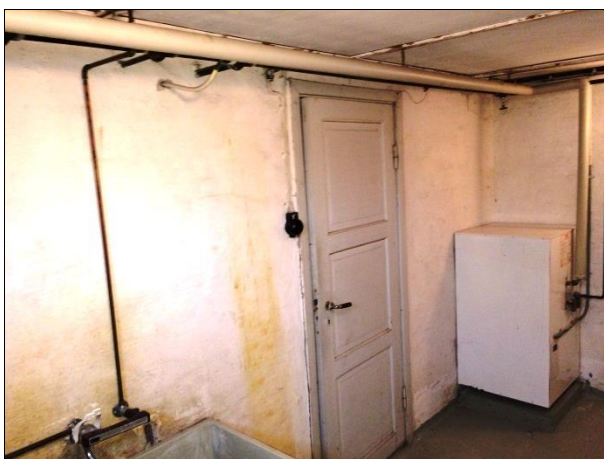
Figur 12: Isolasjon av isopor på vannrør fra varmtvannsbereder i kjeller i Tingvollen 7A.
