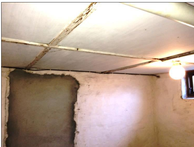
Figur 3: Platekledning i vaskerommet i Tingvollen 7A, eternitplater med asbestinnhold.
