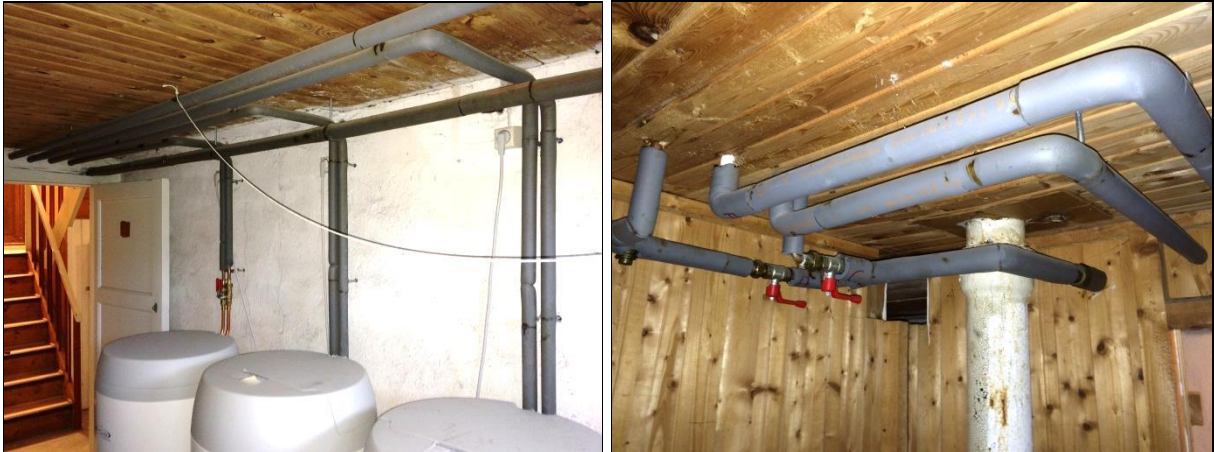
Figur 13: Isolasjon av cellegummi i felleskjelleren i Tingvollen 11.
