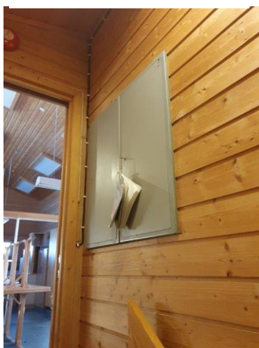
Bilde: el tavle i korridor
