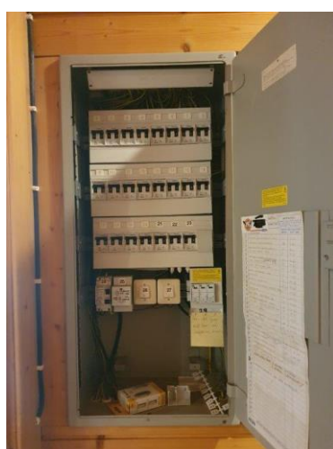
Bilde: el tavle i korridor
