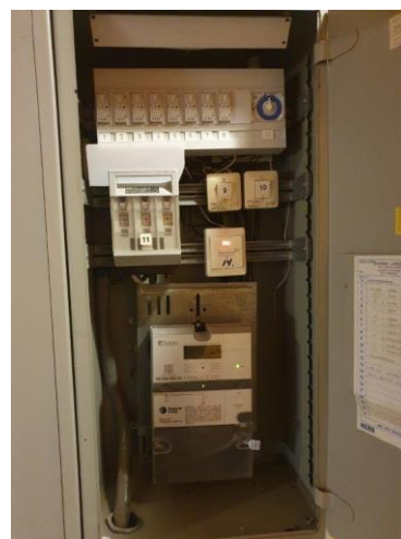
Bilde: el tavle i korridor
