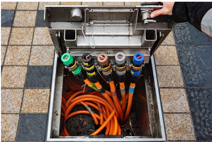
Bilde 7.5.1 Eksempel kabelmonterte kontakter, Trondheim Torv
