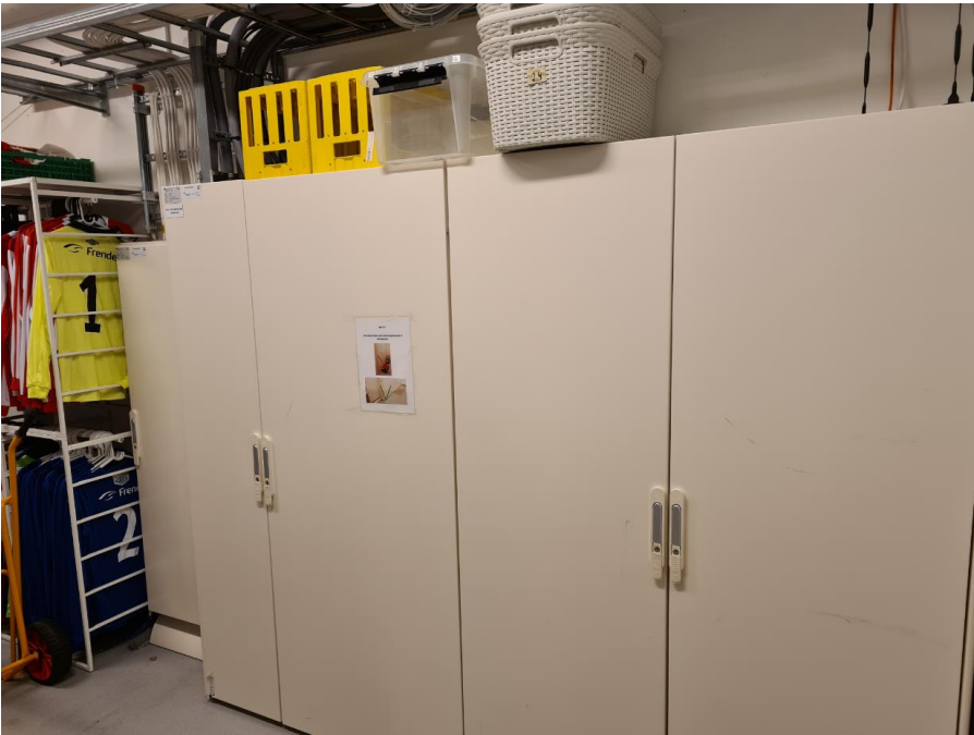
Hovedtavle i vaskerom
