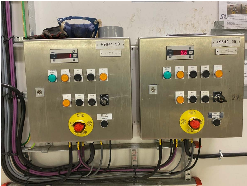
Bilde 5: Kontrollpanel for påfylling av biorest – finnes også kamera for å se tilkobling til teleskop
