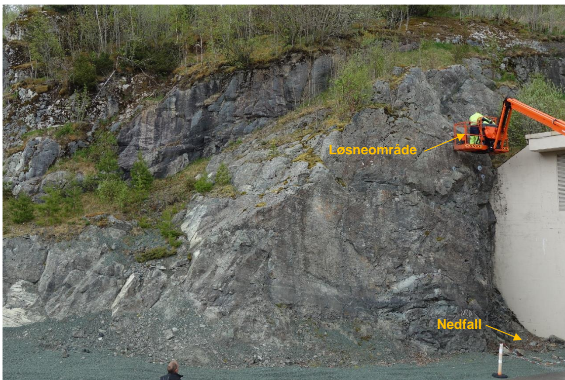
Figur 2: Skjæring i høyre side, nedfall høsten 2019 er markert.
