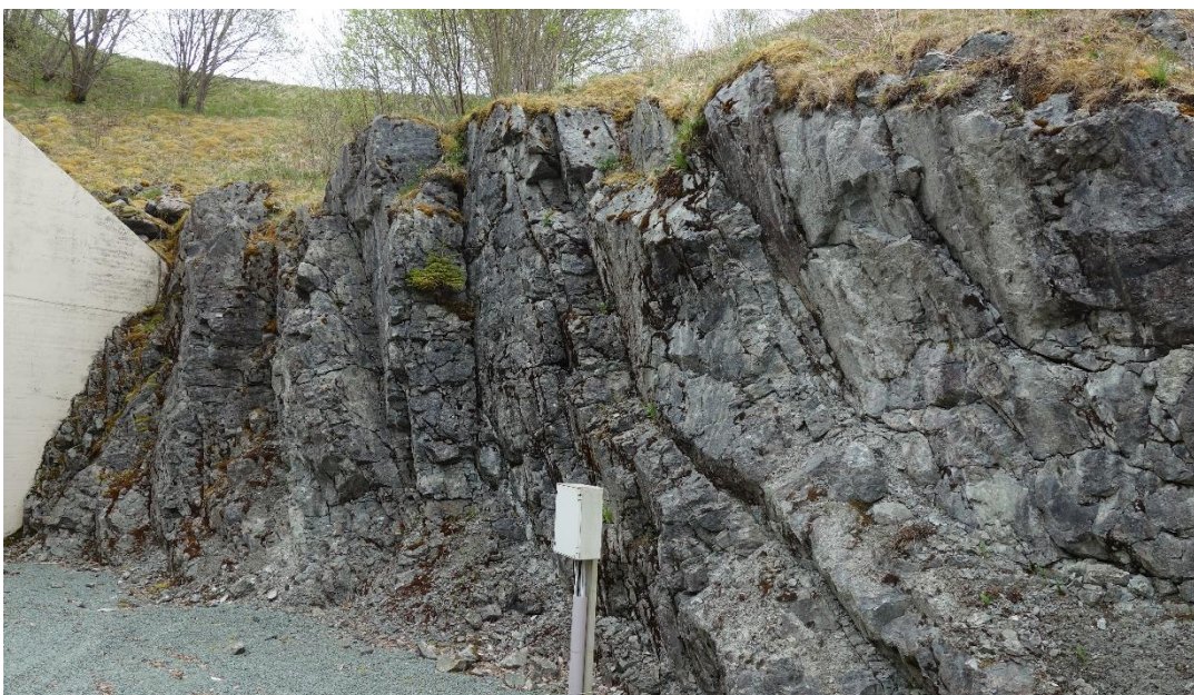
Figur 1: Skjæring i høyre side. Benket utseende med dominerende steilt sprekkesett.
