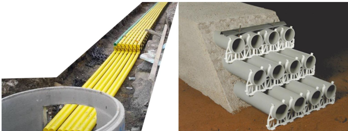
Figur 11: Eksempel på trekkerør og uttakskum. (Fjeldseth)
