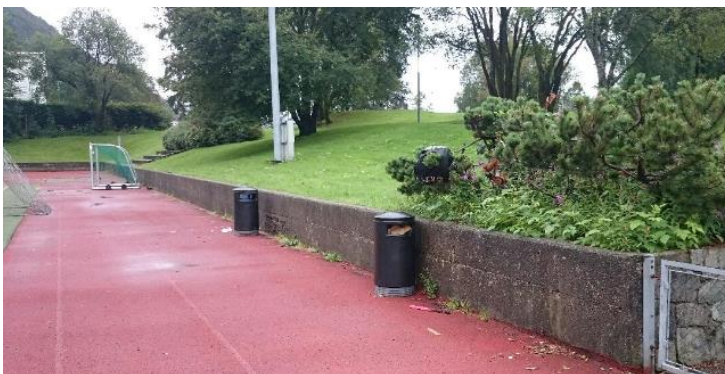
Figur 2 Bildet viser muren som går langs vestre og sørlige kant av banen. Muren skal rives. Foto er tatt mot sør.
