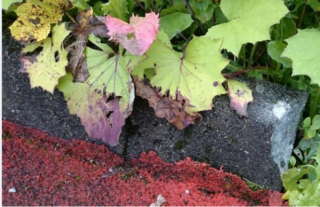
Figur 4 Bildet viser kantstein av betong som ligger langs østre kant av banen. Kantsteinen skal fjernes.
