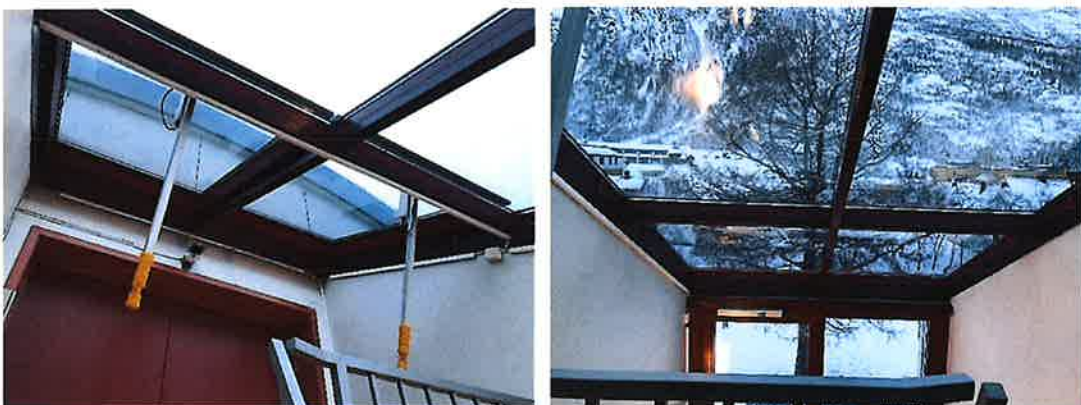
Bilder over viser glasstaket og røykluker. Døren er inn til teknisk rom.
